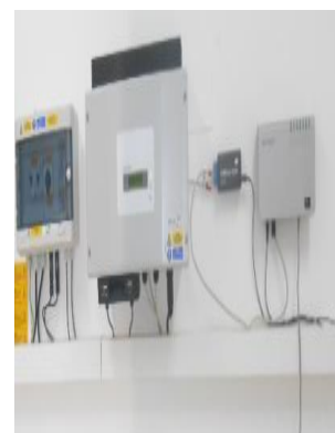
Fig. 2.b. Solar sensor box
